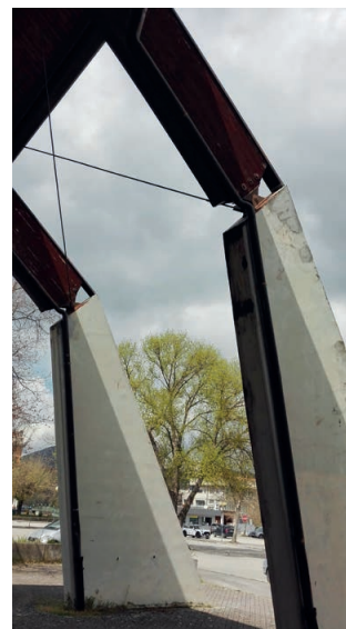
L'aggancio della struttura lignea ai piloni di cemento armato rappresenta una delle maggiori criticità
